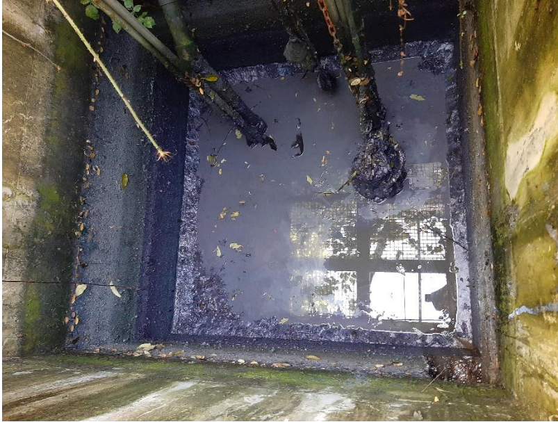
Fosse de relevage avant nettoyage
