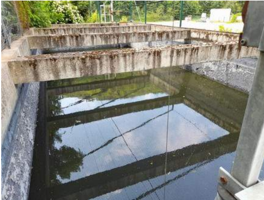
Effluents du bassin de pré-traitement (240 m 3 environ)
