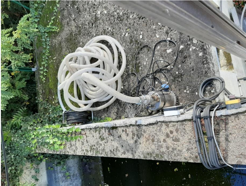
Dispositif de pompage pour rejet en STEP
