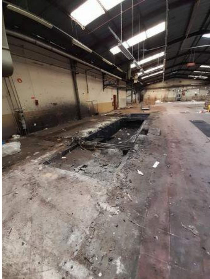
Vue du sol et de la rétention d'une ancienne machine d'impression
