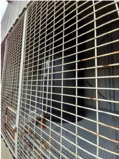
Cuve d'acide acétique
